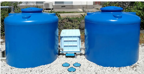
図6 雨水タンク(6m 3 :3m 3 ×2基)
